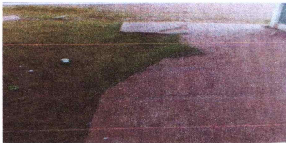
Foto 5: El piso de atrás la escuela está deteriorada sin mantenimiento.
