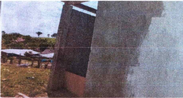
Foto 3: Hce falta puertas las aulas y cocina se mantiene abierto todos los días.
