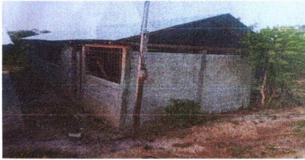
Foto 1: Refuerzo de estructura del techo (costaneras) con daños sin mantenimiento la cocina del establecimiento.
