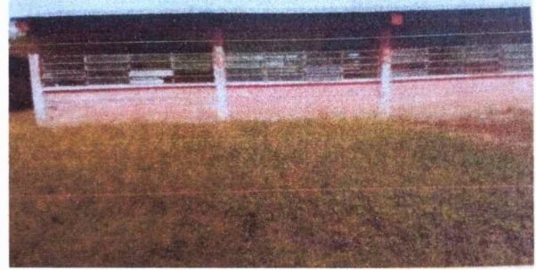
Foto 2: Parte atrás de las aulas se aprecia deterioros, principalmente las ventanas y piso.
