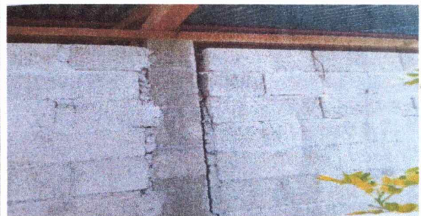
Foto 4: Se observa rajaduras de la cocina hace falta repello y fundición.
